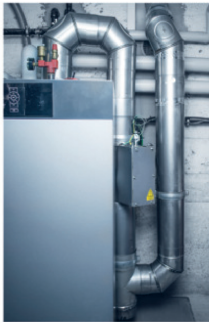
OekoTube-Inside Mehrfamilienhaus, Walenstadt SG, Pelletkessel 24 kW
