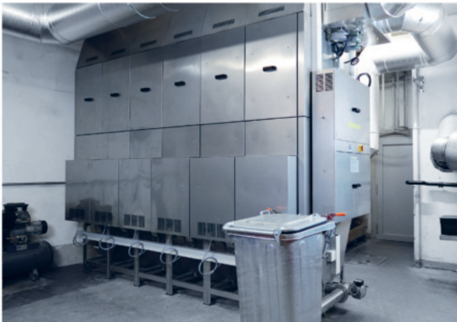
OekoRona 6M Gymnasium Vaduz FL, Hackschnitzelfeuerung 850 kW - W50
