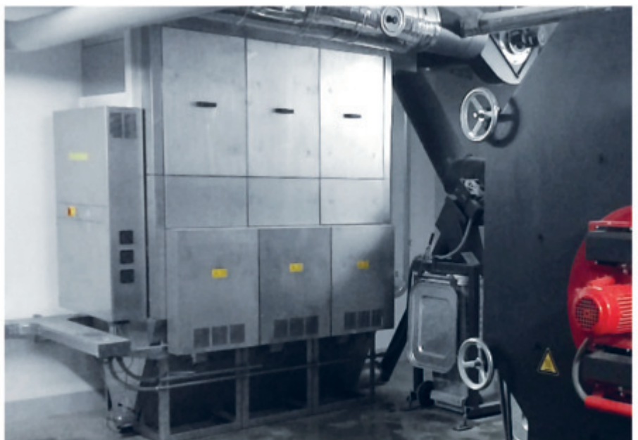
OekoRona 3M Schulhaus Carvico IT, Hackschnitzelfeuerung 540 kW - W50
