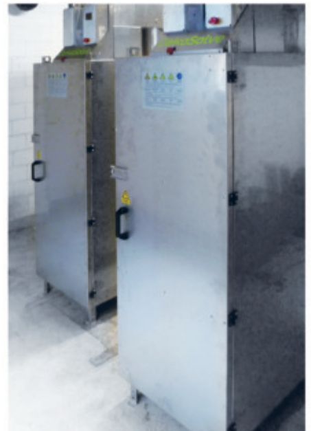
2 x OekoRona 110 Schulhaus Uzwil SG, Pelletfeuerung 2 x 110 kW
